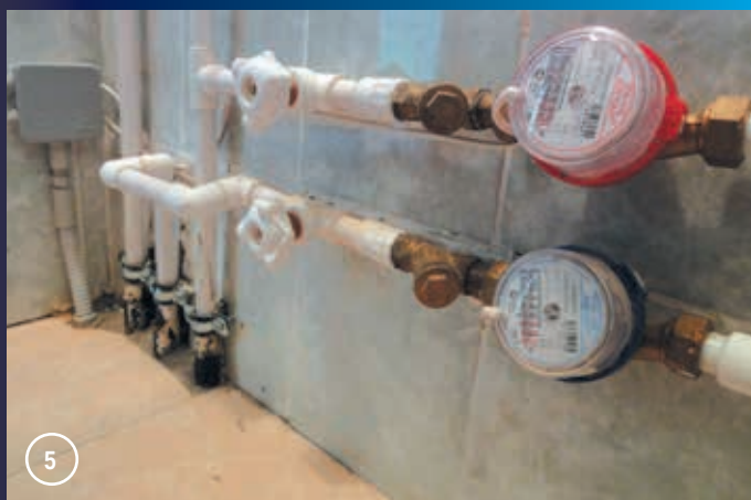
Подключение счетчиков холодной и горячей воды
