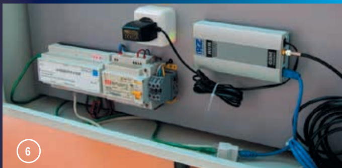
Щит с оборудованием: концентраторы, блок питания, маршрутизатор
