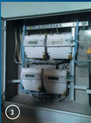
Подключение счетчиков электрической энергии
